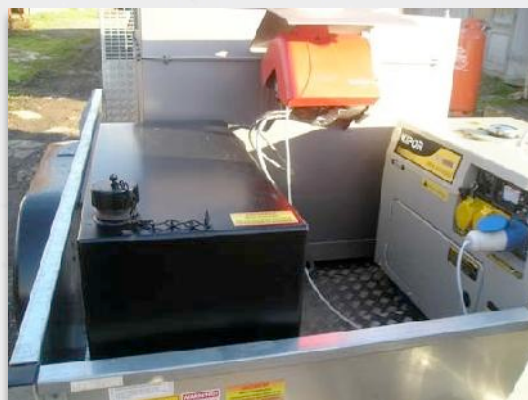
Rezervorul pentru combustibil și generatorul
