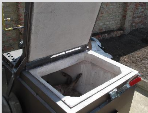
Camera de ardere pregătită de incinerare
